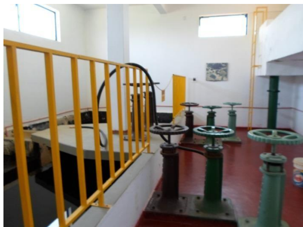
Figura 18: Elevatória de água tratada Fonte: Conen
