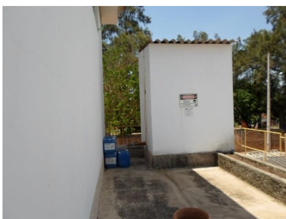
Figura 19: Sala de aplicação do cloro Fonte: Conen
