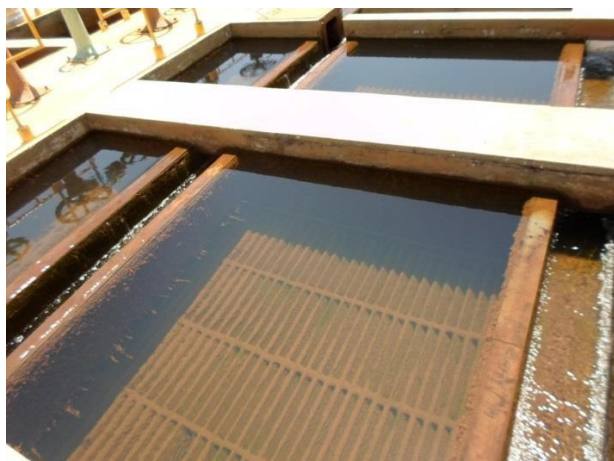
Figura 17: Decantadores Fonte: Conen
