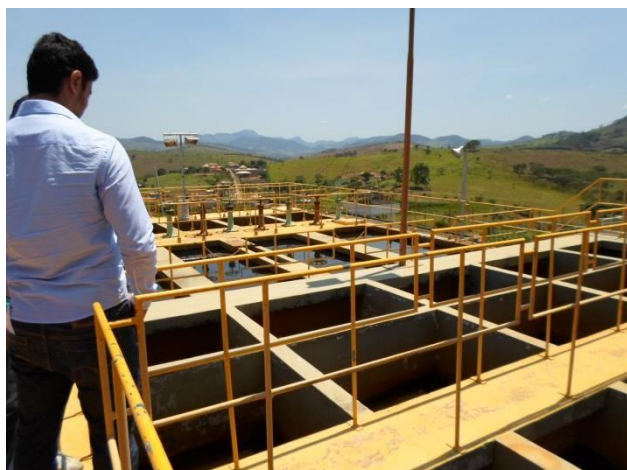
Figura 15: Instalações de tratamento (ETA) Fonte: Conen
